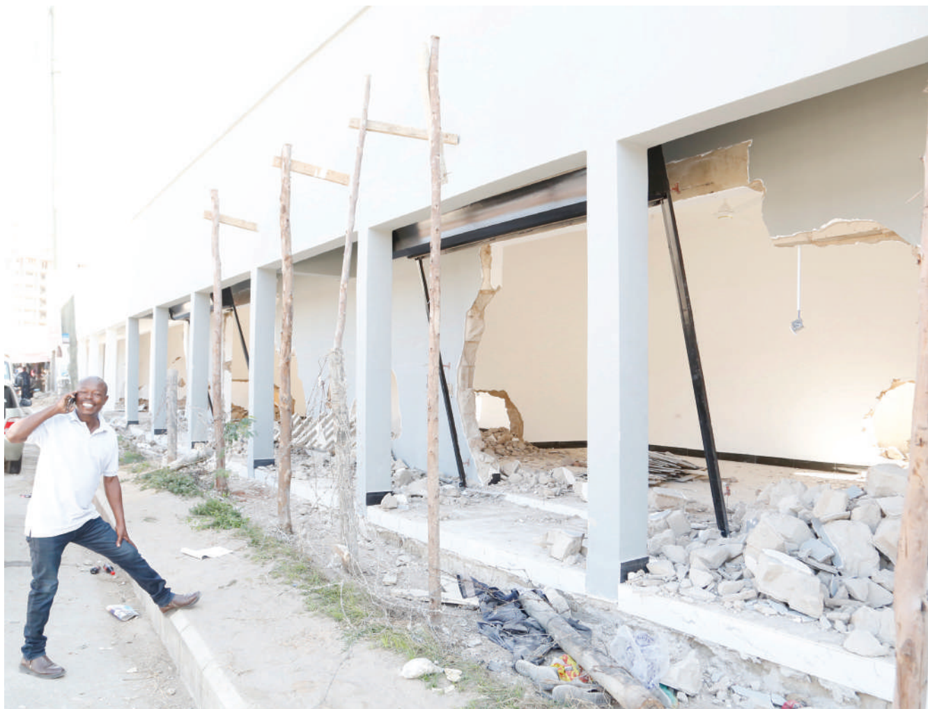
Mwonekano wa mbele wa shule ya Sekondari ya Central ya jijini Dodoma, baada ya maduka yaliyojengwa shuleni hapo, kuvunjwa na uongozi wa Jiji hilo juzi, kwa madai kuwa yamejengwa bila kibali. PICHA: IBRAHIM JOSEPH
