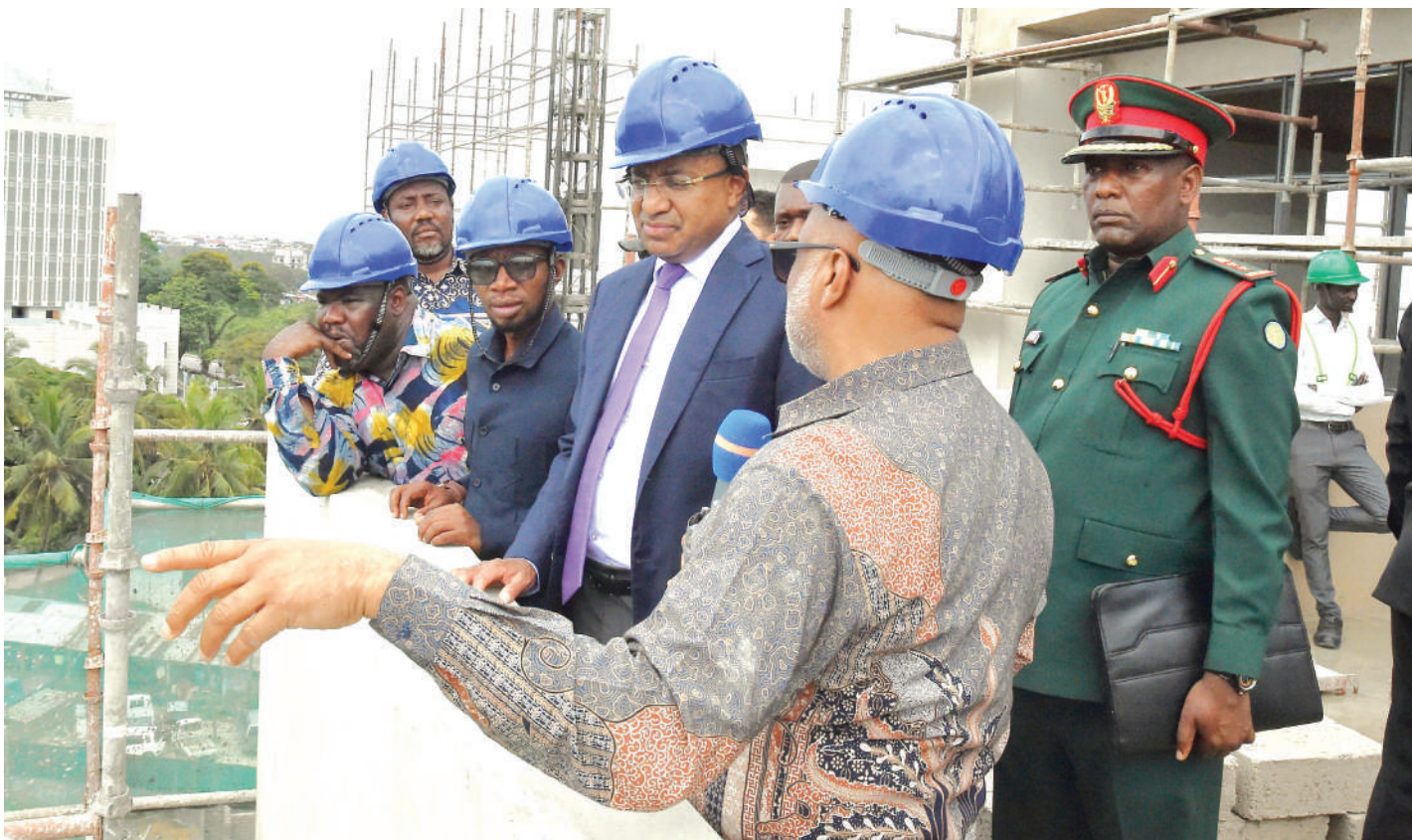
Rais wa Zanzibar, Dk. Hussein Ali Mwinyi (wa pili kulia), akipata maelezo ya maendeleo ya ujenzi wa Hospitali ya Mkoa wa Mjini Magharibi Unguja kutoka kwa Waziri wa Afya Zanzibar, Nasser Ahmed Mazrui, inayojengwa katika eneo la Lumumba Wilaya ya Mjini Unguja. PICHA: IKULU
