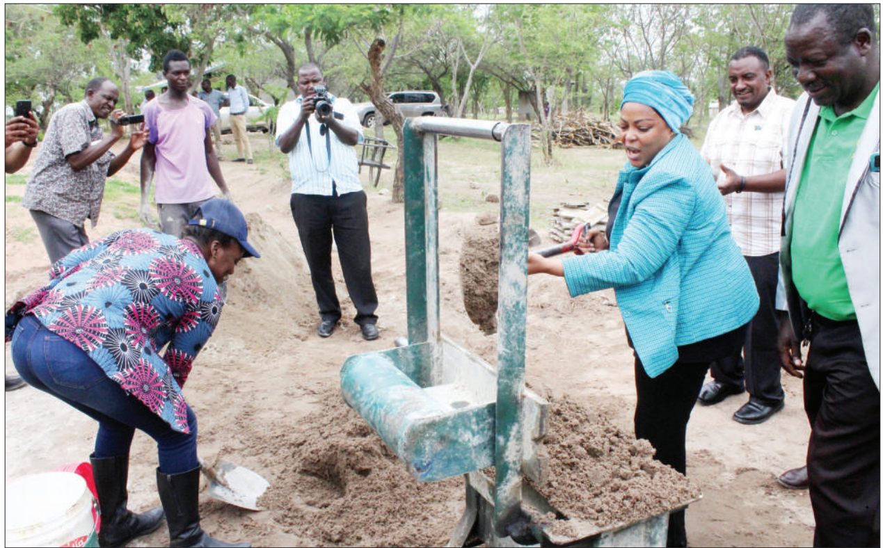
Mkuu wa Mkoa wa Shinyanga, Sophia Mjema (kulia), akishiriki kufyatua tofali kwa ajili ya ujenzi wa vyumba vitatu vya madarasa katika Shule ya Sekondari Solwa wilayani Shinyanga jana. Kushoto ni Mkurugenzi wa Halmashauri ya Wilaya hiyo, Nice Munissy. PICHA: MARCO MADUHU
