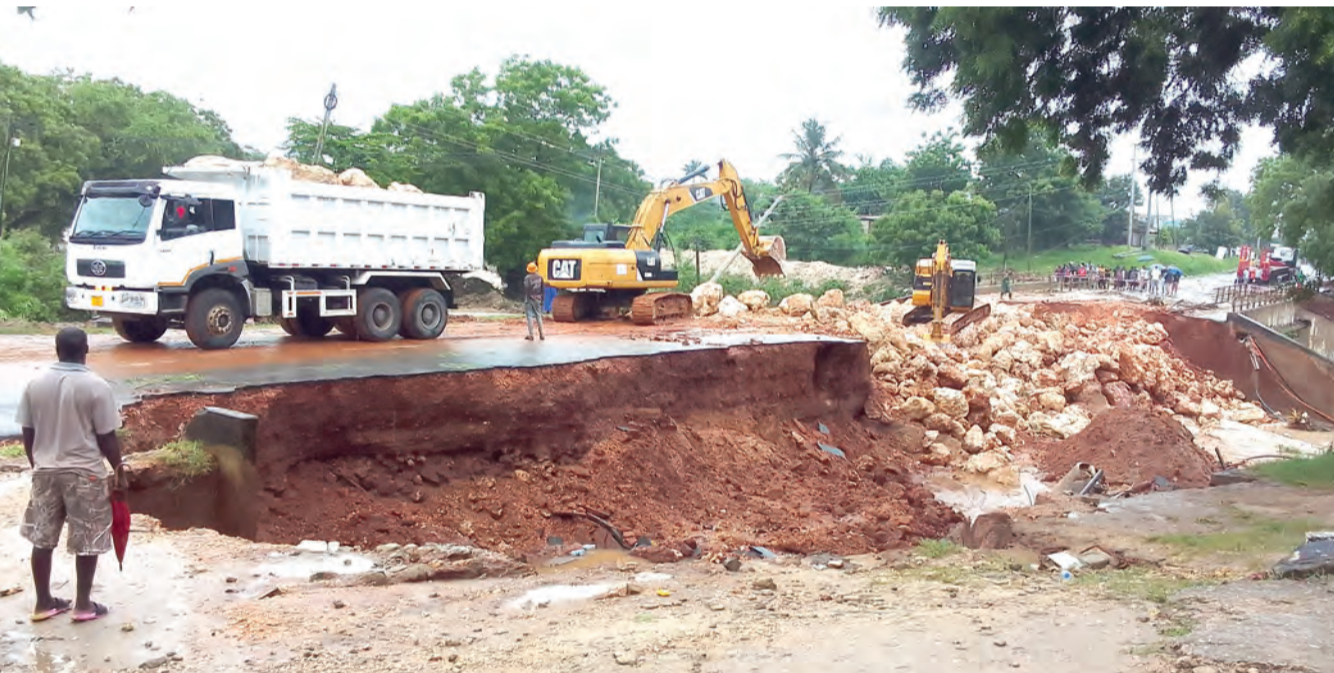
Ukarabati wa daraja la Kunduchi wilayani Kinondoni ukiendelea baada ya kuzolewa na maji ya mvua inayoendelea kunyesha jijini Dar es Salaam. PICHA: ELIZABETH ZAYA
