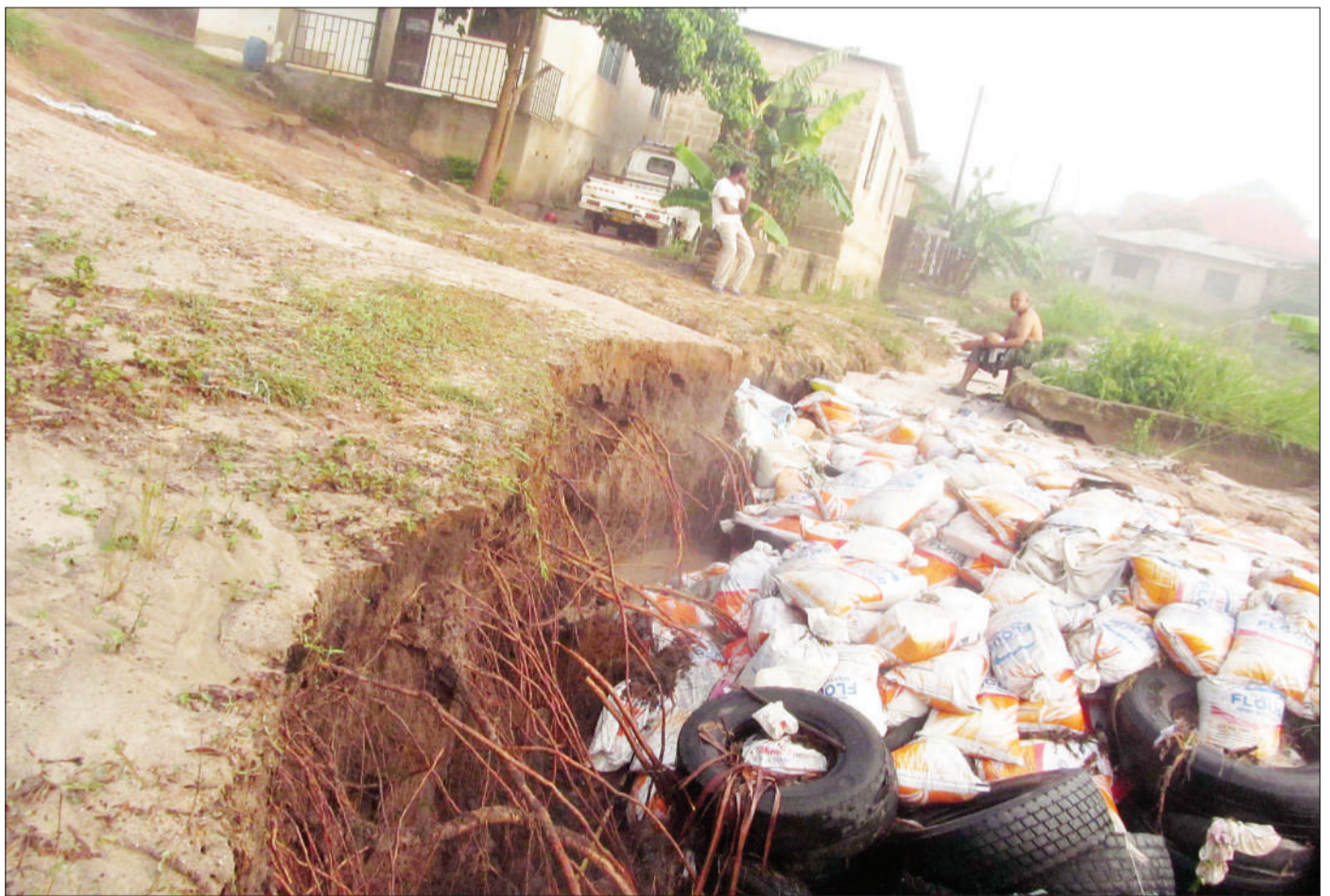
Moja ya eneo la Mtaa wa King'azi B, Kata ya Kwembe, likiwa limeharibiwa na mvua zilizonyesha jijini Dar es Salaam jana, licha ya jitihada za kuweka viroba vya mchanga na matairi ili kuzuia mmomonyoko. PICHA: SABATO KASIKA
