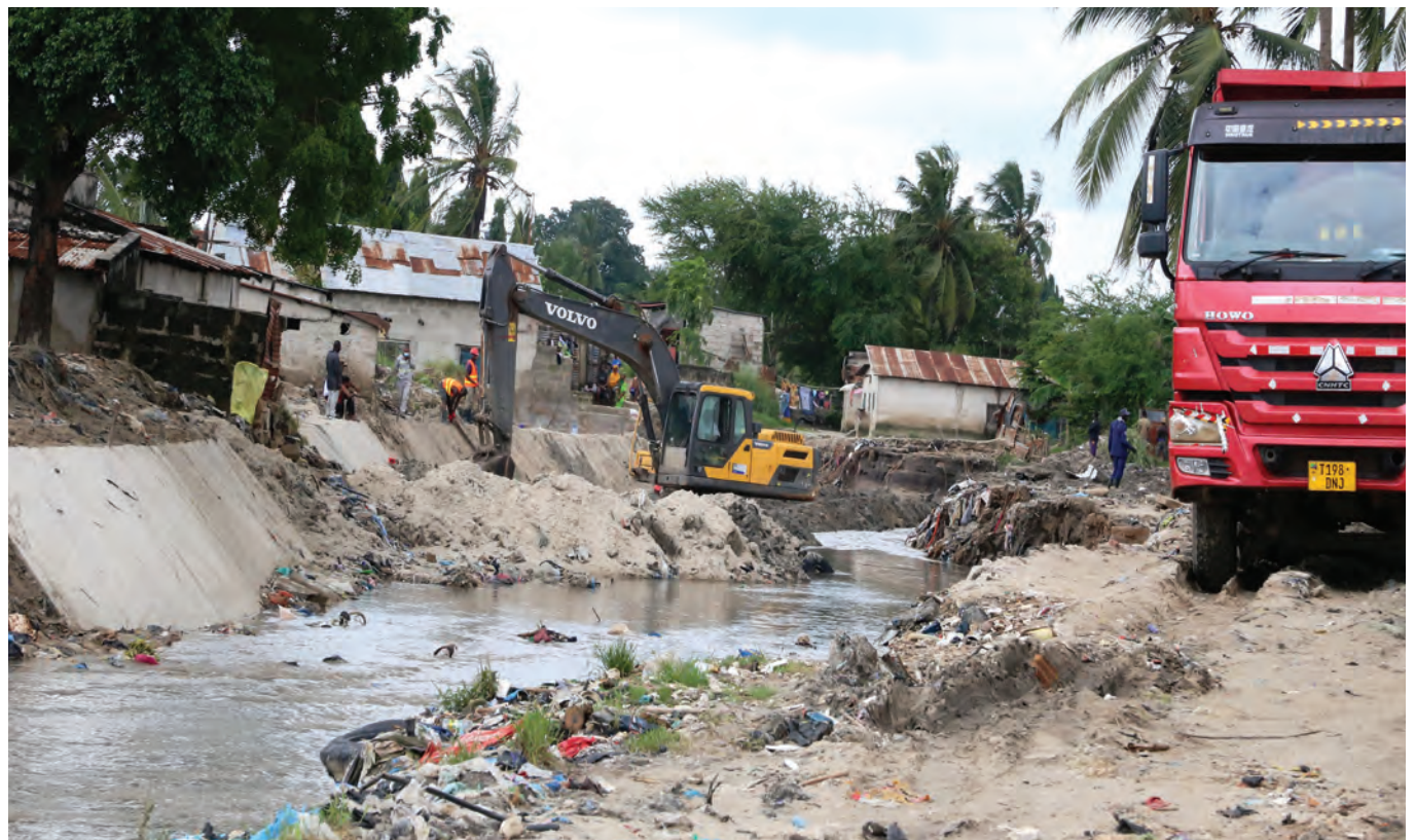
Katapila likipanua bonde la mto Ng'ombe lililopo eneo la kati ya kwa Mtogole na Ali Maua, wilayani Kinondoni, jijini Dar es Salaam, ili kuondoa mafuriko kwenye eneo hilo. Picha: MPIGAPICHA WETU.
