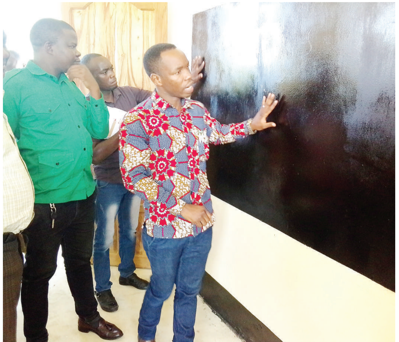
Naibu Waziri Ofisi ya Waziri Mkuu Kazi, Vijana na Ajira, Patrobas Katambi, ambaye pia ni Mbunge wa Jimbo la Shinyanga Mjini, akikagua ubora wa Ubao katika shule ya sekondari Kolandoto Manispaa ya Shinyanga, leo/ jana, alipofika kukagua maendeleo ya ujenzi wa vyumba viwili vya madarasa shuleni hapo, kwa fedha za UVIKO 19 Sh.milioni 40 na kuridhishwa na hatua ya ujenzi wa vyumba hivyo. Picha: MARCO MADUHU
