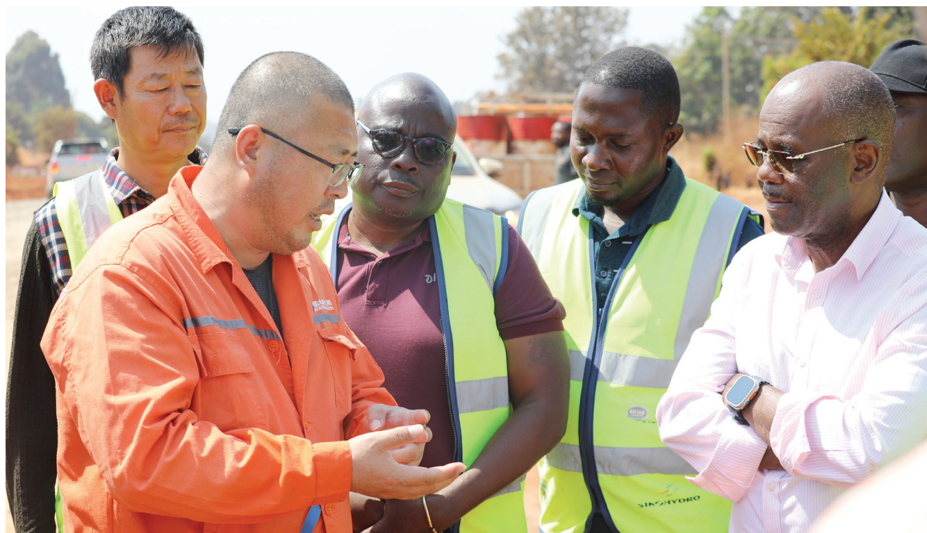
Waziri wa Ujenzi na Uchukuzi, Profesa Makame Mbarawa akimsikiliza mkandarasi wa kampuni ya Synohydro Corporation Limited inayojenga barabara ya Kanyani Junction hadi Mvungwe yenye urefu wa Kilomita 70.5 mkoani Kigoma jana. PICHA: MPIGAPICHA WETU
