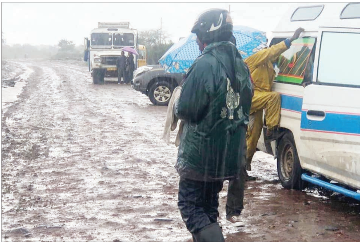
Mvua zinaoendelea kunyesha maeneo mbalimbali ya Mkoa wa Arusha, zimevunja daraja katika korongo la Oljoro Kata ya Oljoro, Halmashauri ya Arusha DC, wilayani Arumeru. Kuvunjika kwa daraja hilo kume-kata mawa siliano kati ya Kijiji cha Mbuyuni na Kijiji cha Mirongoine. PI CHA: ALLAN ISACK
