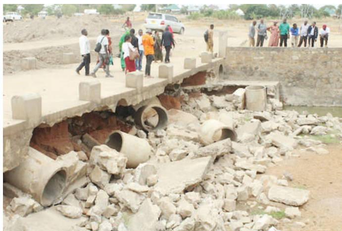
Mwonekano wa Daraja la Iwelyangula linalounganisha kata za Chamaguha na Kitangili, Manispaa ya Shinyanga, likiwa limebomoka kutokana na shughuli za kibinadamu kwenye daraja hilo.
