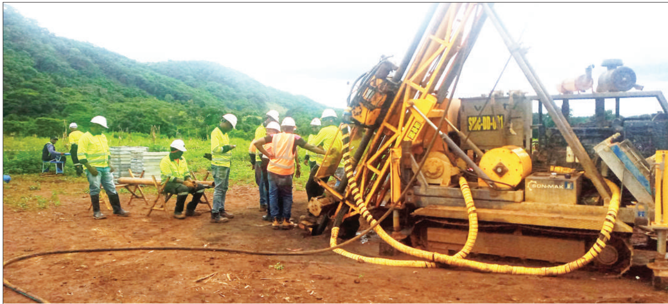
Wataalamu wa Jotoardhi kutoka kampuni ya TGDC kwa kushirikiana na STAMICO wakiendelea na uchorongaji visima katika eneo la Kyejo- Mbaka lilipo Halmashauri ya Busokelo mkoani Mbeya kwa ajili ya uzalishaji wa nishati ya umeme mwishoni kwa wiki. PICHA: GRACE MWAKALINGA
