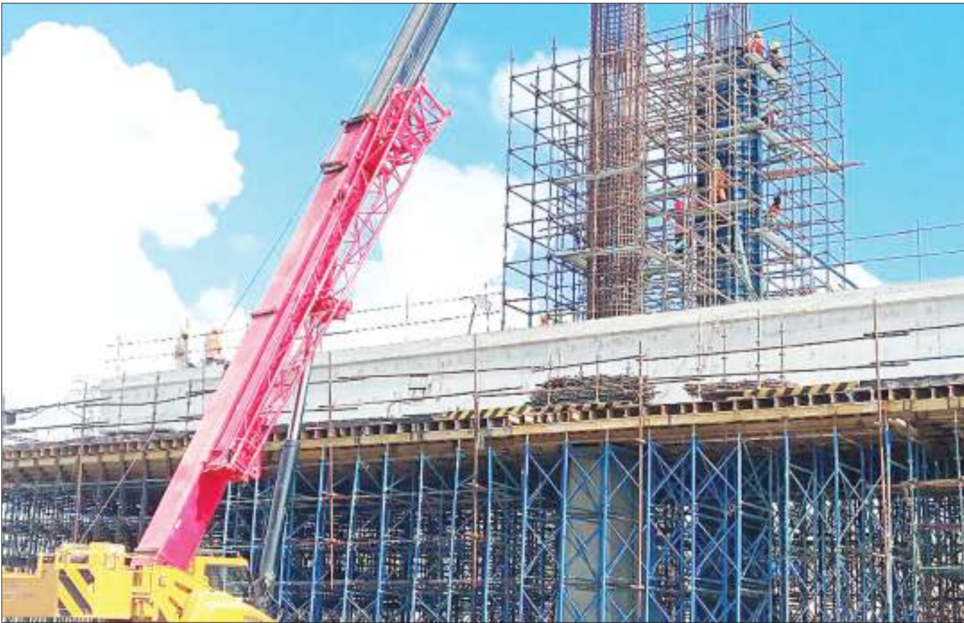
Mafundi wa Kampuni ya Yapi Merkezi wanaojenga reli ya treni ya mwendokasi ya kisasa, wakiendelea na ujenzi wa barabara ya juu maeneo ya Gerezani, jijini Dar es Salaam jana. PICHA: JOSEPH MWENDAPOLE
