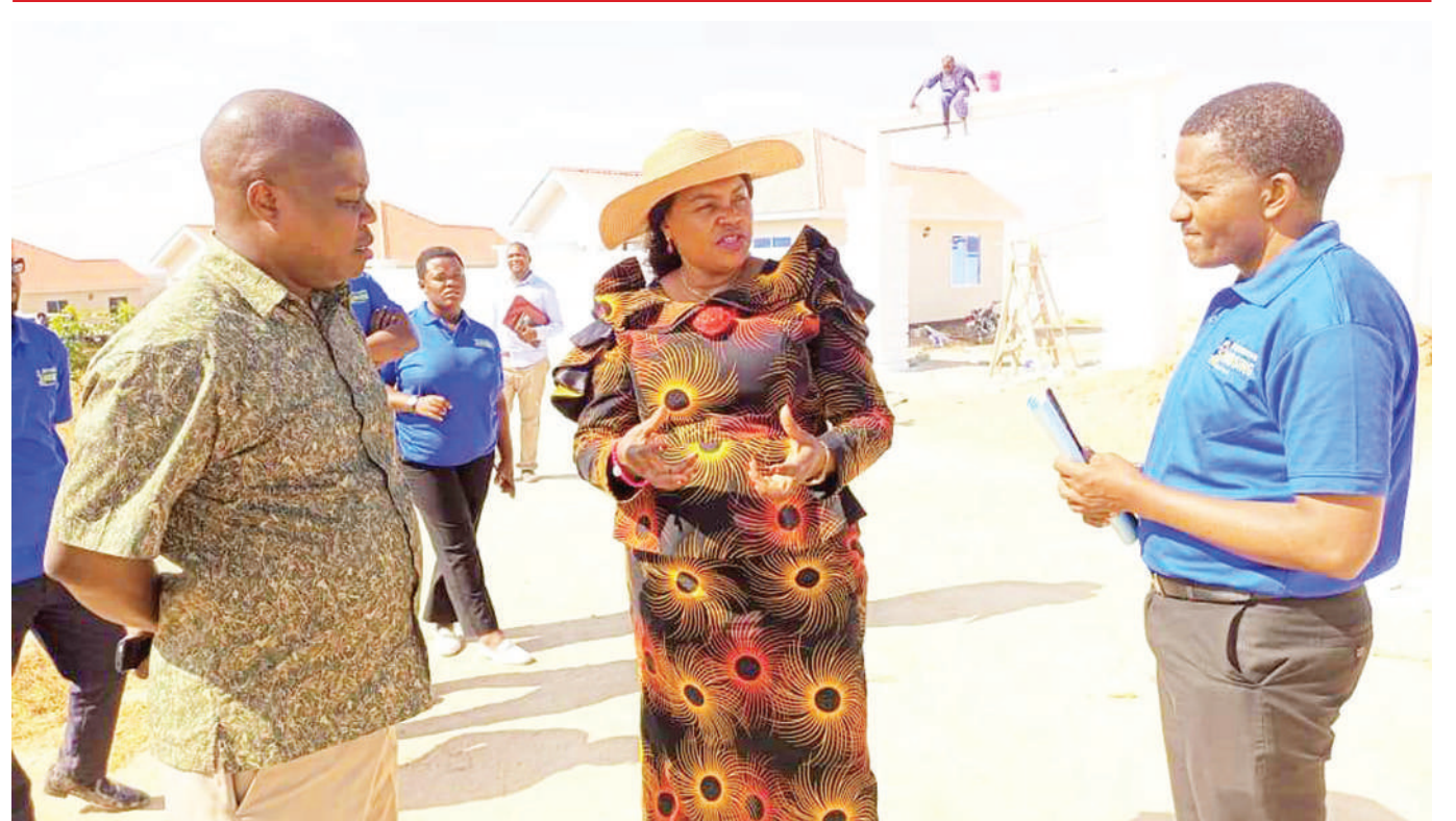
Waziri wa Nchi, Ofisi ya Rais, Menejimenti ya Utumishi wa Umma na Utawala Bora, Jenista Mhagama (katikati), akitoa maelekezo kwa Mkurugenzi Mtendaji wa Watumishi Housing Investment, Dk. Fred Msemwa (kulia), baada ya kukagua maendeleo ya mradi wa ujenzi wa nyumba, eneo la Kisasa Njedengwa, jijini Dodoma jana. PICHA: UTUMISHI
