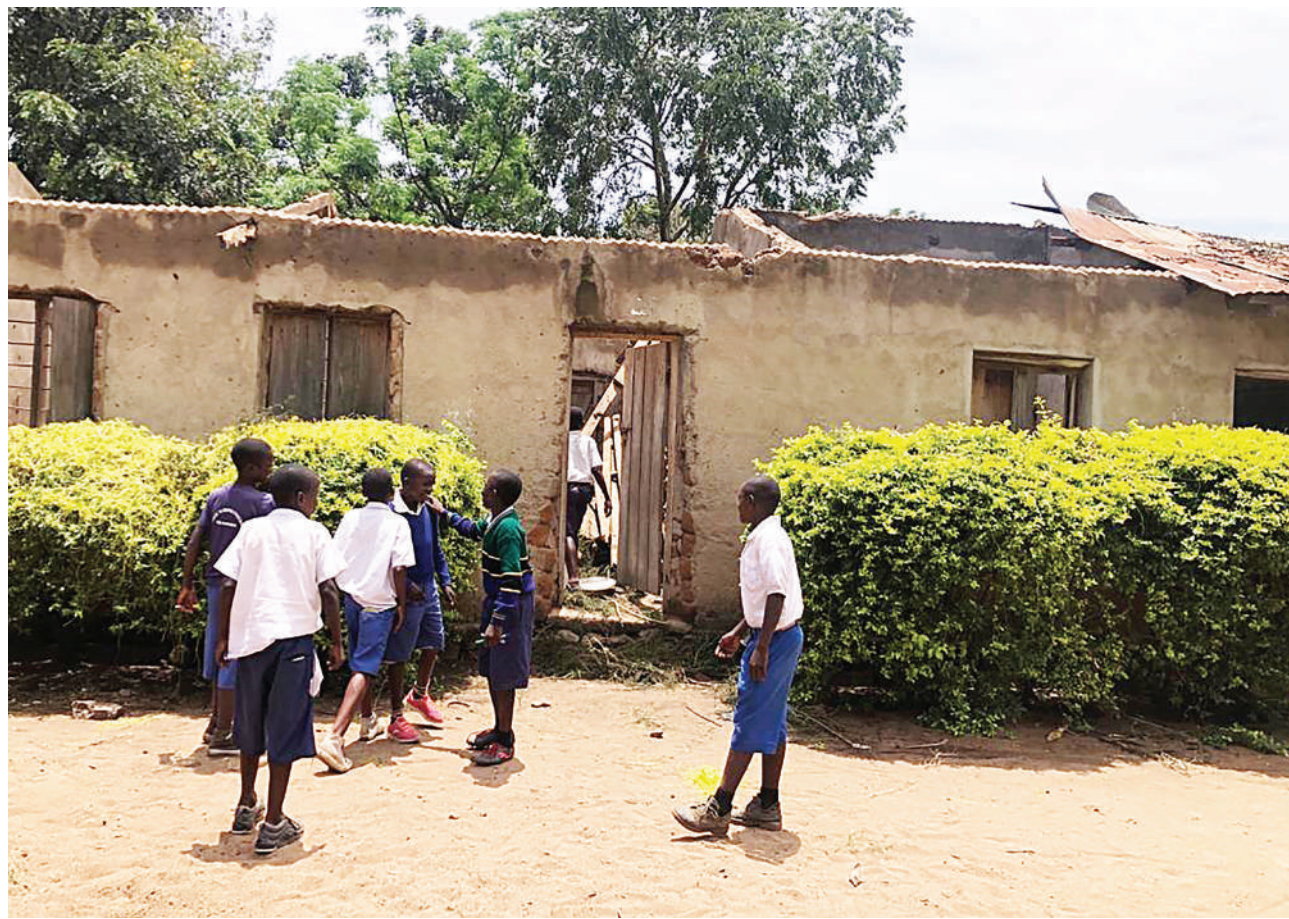
Baadhi ya wanafunzi wa Shule ya Msingi Lyasembe, Kata ya Murangi, Wilaya ya Musoma mkoani Mara, wakiwa nje ya darasa lao jana, lililoezuliwa paa kutokana na mvua kubwa ya upepo iliyonyesha mwishoni mwa wiki. PICHA: MPIGAPI-CHA WETU
