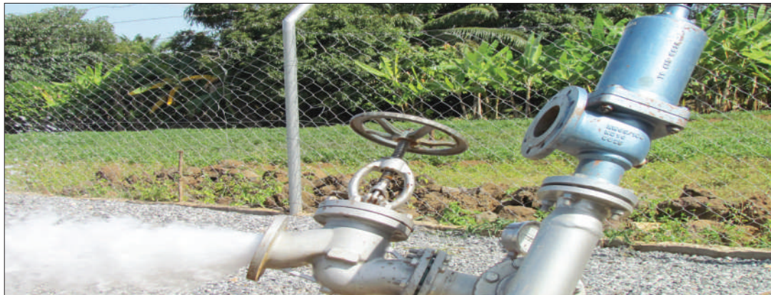
Bomba likitema mvuke unaotoka ardhini 'jotoardhi' ili kuzalisha umeme. PICHA: MTANDAO
