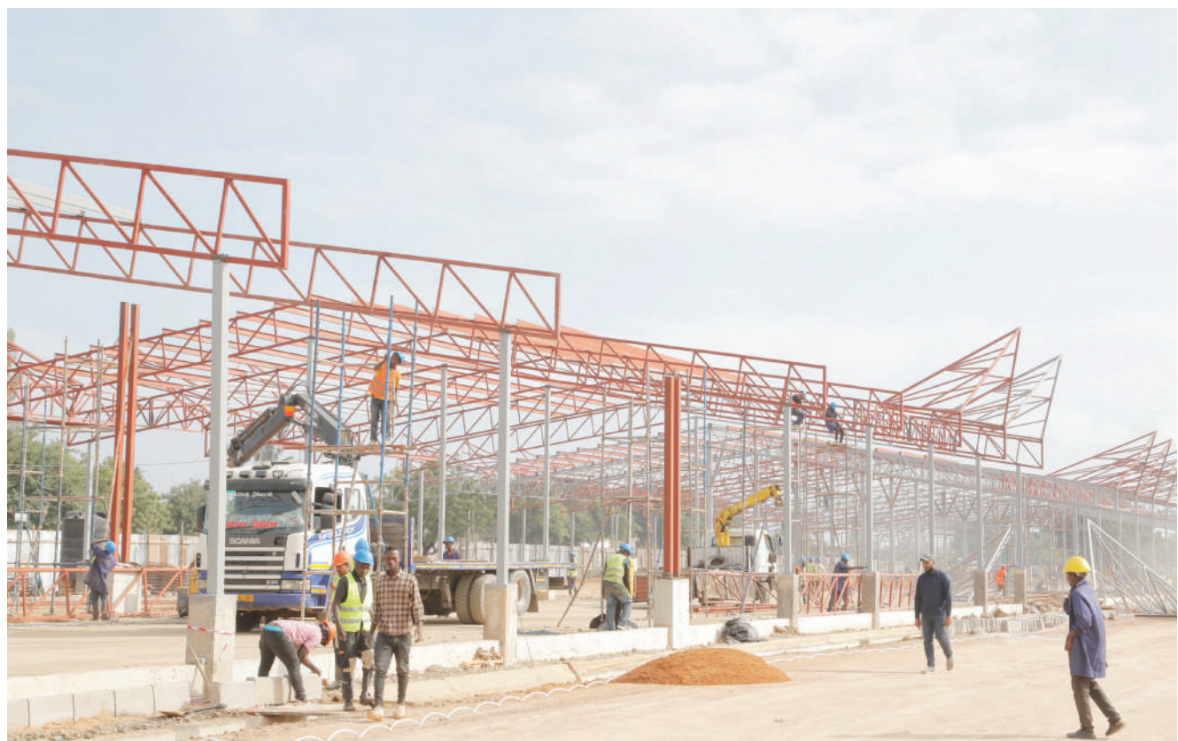
Mafundi wa kampuni ya ujenzi ya Mohammed Builders Ltd, wakiendelea na ujenzi wa mradi wa soko la wafanyabiashara wadogo maarufu machinga, katika eneo la Bahi Road, jijini Dodoma jana. Eneo hilo, linatarajiwa kutumiwa na idadi ya wamachinga zaidi ya 4,000. PICHA: IBRAHIM JOSEPH
