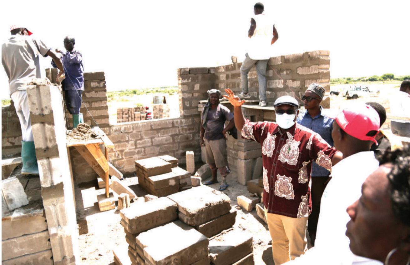
Mkuu wa Mkoa wa Mwanza, John Mongella (aliyevaa barakoa), akikagua ujenzi wa hospitali ya Wilaya ya Kwimba, inayojengwa katika eneo la Icheja jana. PICTA: NEEMA EMMANUEL
