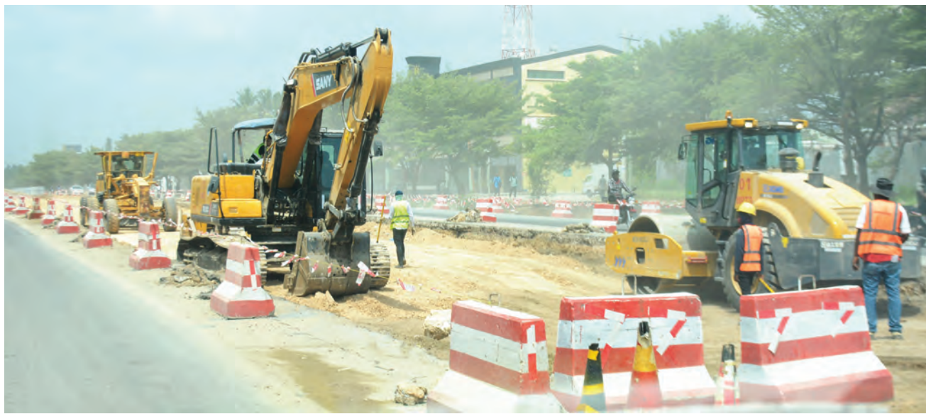
Mafundi wa kampuni ya Sinohydro wakiendelea na ujenzi wa barabara ya Mabasi Yaendayo Haraka (BRT), Vingunguti, Dar es Salaam, jana. PICHA: JUMANNE JUMA
