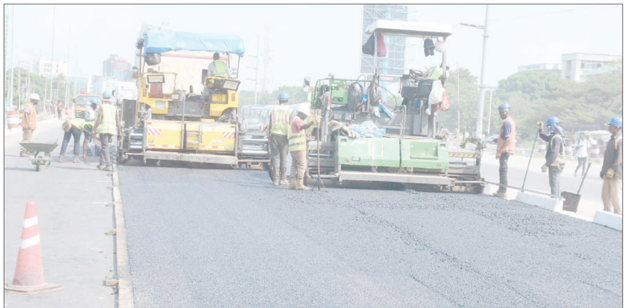
Mafundi wa kampuni ya ujenzi ya Nippo, wakiendelea na ujenzi wa barabara ya Bagamoyo kutoka Mwenge hadi Morocco jijini Dar es Salaam jana. PICHA: JUMANNE JUMA
