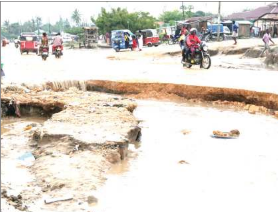
Sehemu ya barabara ya Mbagala Kiburugwa wilayani Tembeke iliyojengwa hivi karibuni ikiwa imeharibika kutokana na mvua zinazoendelea kunyesha jijini Dar es Salaam. PICHA: SELEMANI MPOCHI
